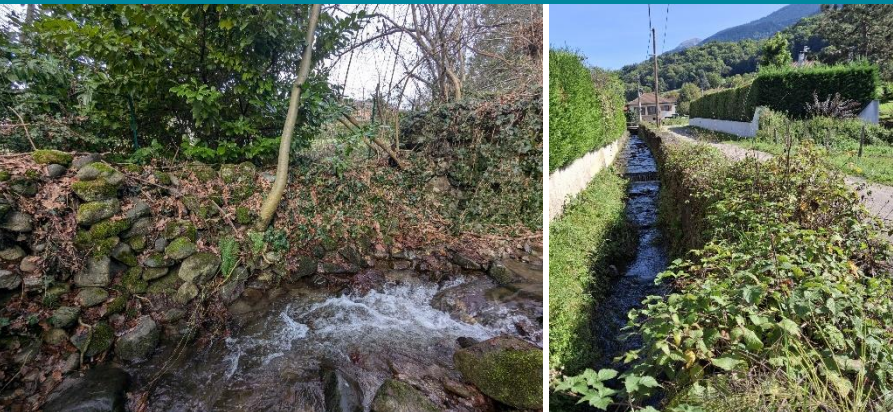
DES MURS ET MERLONS DE PROTECTION ALTÉRÉS
